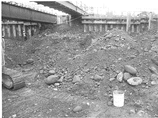
写真-2 礫発生状況（開削箇所）
